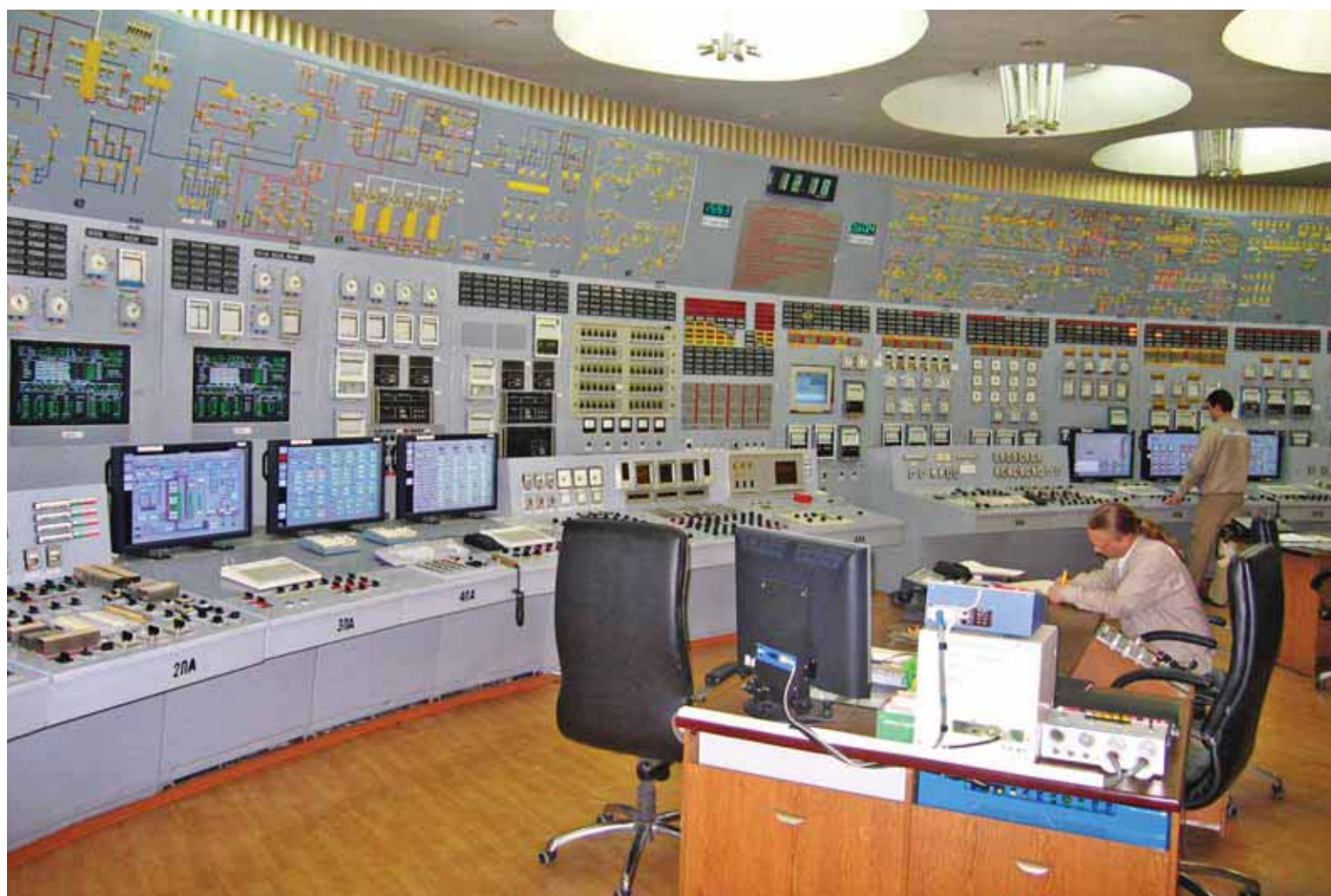
БЩУ энергоблока ЮАЭС после реконструкции ИВС
