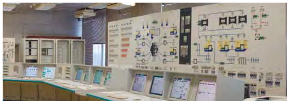
Январь 2009 г. Полигон АСУ ТП ОАО «ЭНИЦ», блочный пульт управления для АЭС «Бушер-1»
