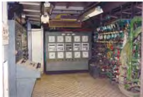
80-е гг. XX века, пульт управления теплогидравлического стенда №108 «ЭНИС ВНИИАЭС» в помещении котельной ГРЭС №3 им. Р.Э. Классона
