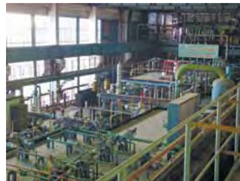
Август 2007 г. Общий вид стендового зала (стендовый корпус ОАО «ЭНИЦ»)
