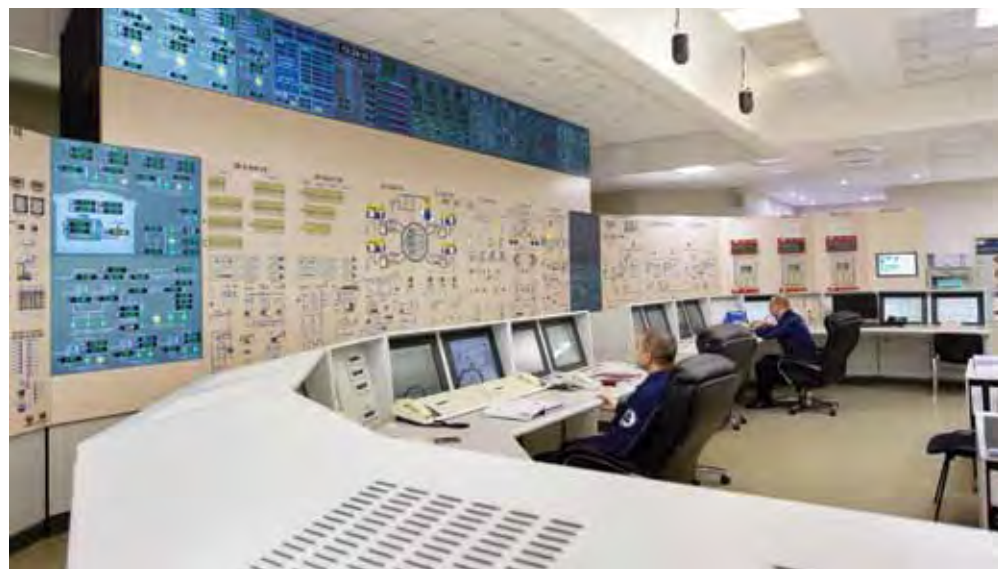
Блочный пункт управления энергоблока №4
