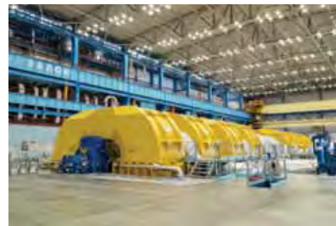
Машинный зал блока №3
