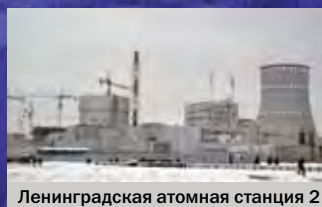
Ленинградская атомная станция 2
