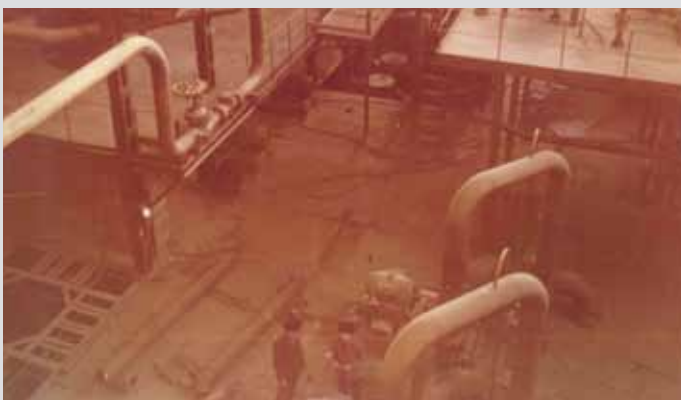
Испытание оборудования блока № 3, БАЭС
