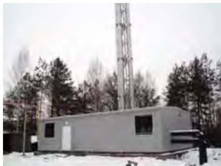
Модульная газовая котельная
